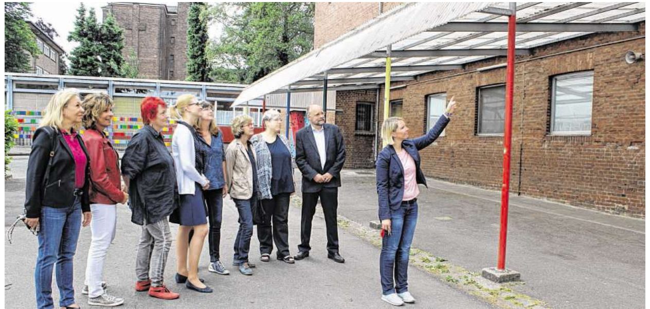
Martina Eichler zeigt einigen ihrer Schulleiter-Kollegen Schäden am Vordach der GGS Palenberg. FOTOS: GÜNTHER VON FRICKEN
